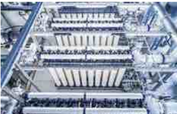
Ultrafiltrationsanlage zur Wasserbehandlung (T-Rack®-System)
